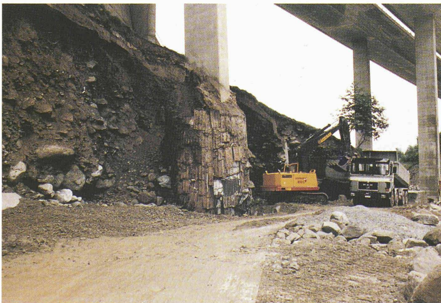
Fig. 11. – Remblayage du puits de fondation de la pile J et mise en place du corps d'appui pour le mur de soutènement.
