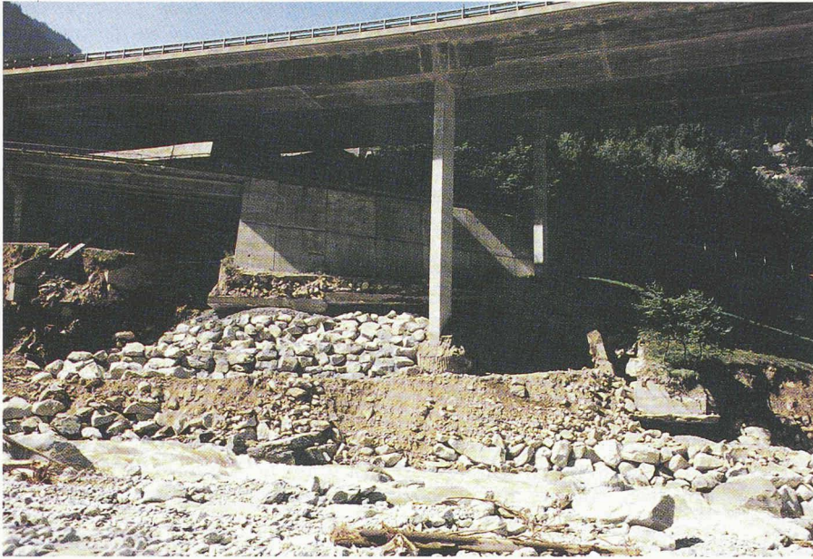
Fig. 12. – 15 000 m 3 de pierres et de matériaux de carrière, réussite du soutien de la culée et du mur de soutènement le 29 août 1987 à minuit. (Photo: T. R. Schneider, 1879/8.)
