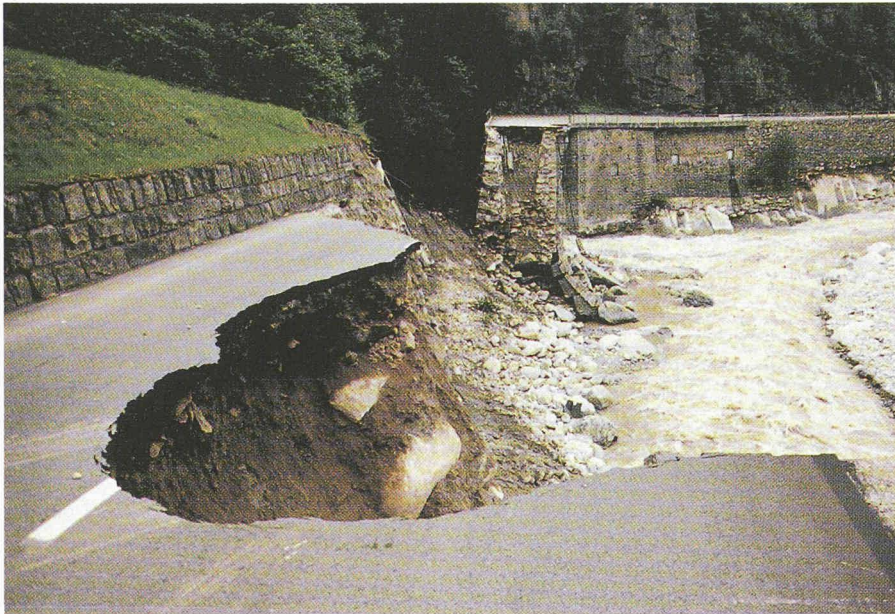
Fig. 9. – Le pont sur la Meienreuss et la route cantonale érodée.
