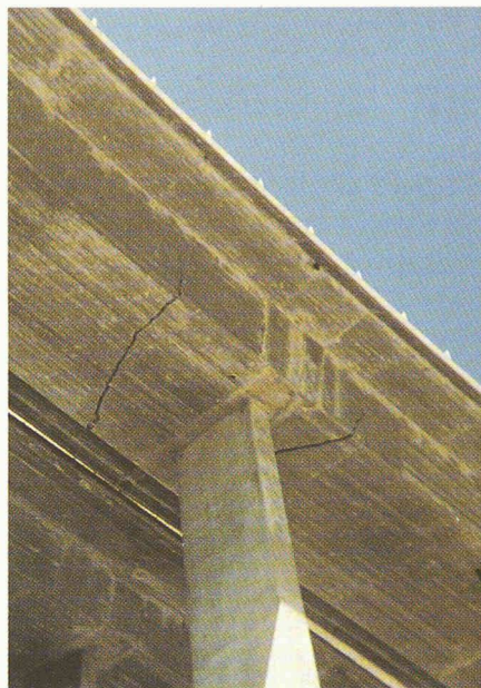
Fig. 5. - Le pont sur la Reuss à Wassen, fissuration du tablier par affaissement des fondations. (Photo: R. Kalbermatten.)
