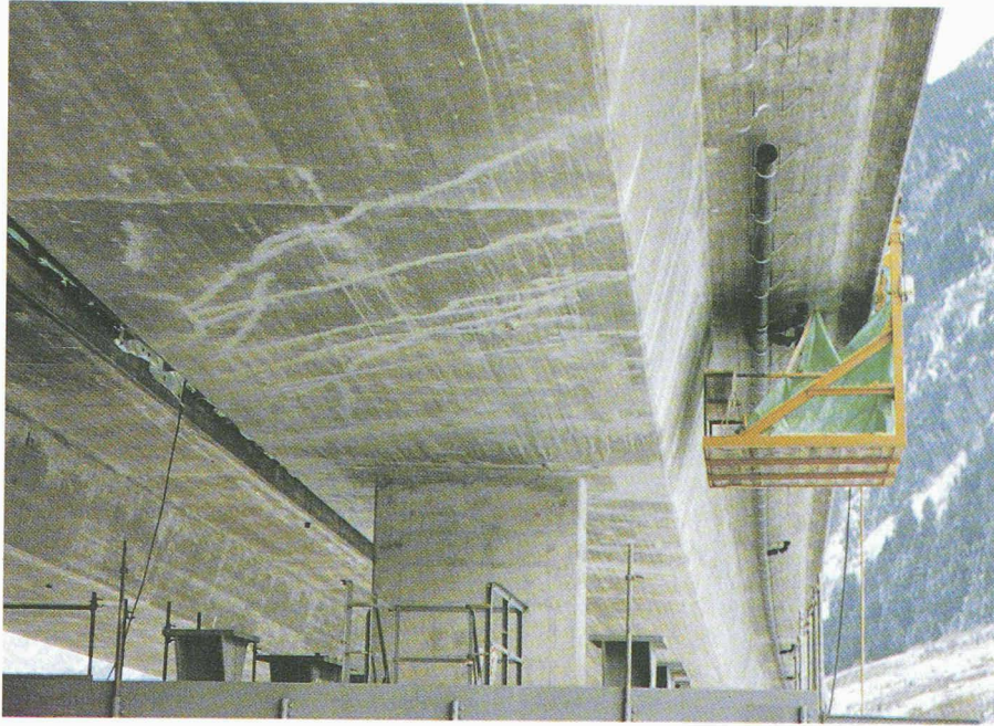
Fig. 19. – Conduite d'évacuation d'eau et fissures injectées dans la superstructure et la tête de pile. (Photo A. von Glutz.)
