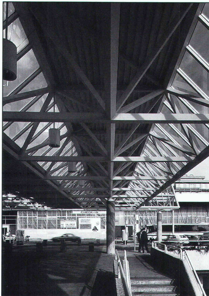
Poutres triangulaires en RHS au-dessus de la station d'autobus à l'aéroport de Genève-Cointrin.
