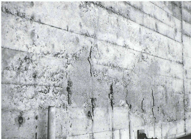
Fig. 3. – Eclats de béton sur étriers affleurants
