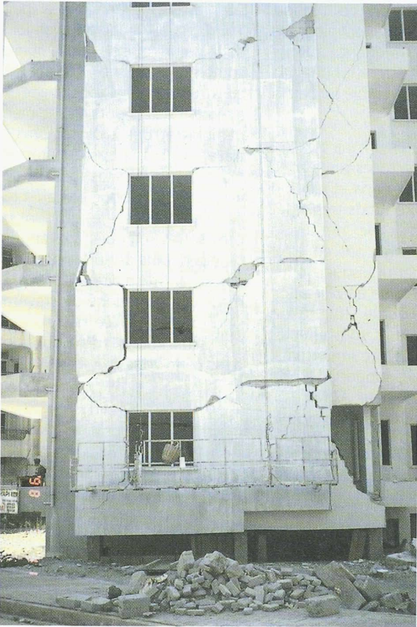
Fig. 3. – Immeuble d'habitation (gros œuvre) présentant des dégâts typiques de murs de remplissage en maçonnerie, avec les fissures caractéristiques en croix (niveau de dégâts 3)
