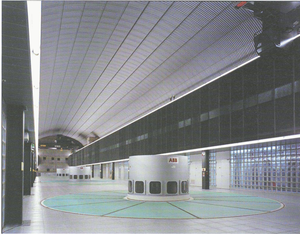
Fig. 3. - Partie visible de la caverne, comprenant les couvercles des alternateurs (Photo H. Preisig, Sion)
