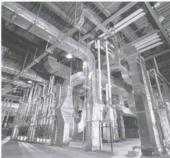
Fig. 3: Vue de l'ensemble des amenées d'air et de fluides au niveau du plafond d'une salle blanche. Le domaine biomédical exige des taux de renouvellement d'air particulièrement élevés et les équipements occupent souvent plus d'espace que la salle elle-même.
