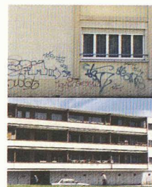
Des graffitis à Genève : un indicateur de l'entretien courant d'un immeuble résidentiel (Photos R. Lawrence)
