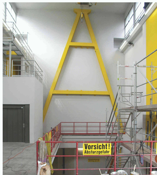
Dispositif parasismique en acier (jaune, à gauche) et en béton armé (jaune, à droite) (Image: Thomas Wenk)
