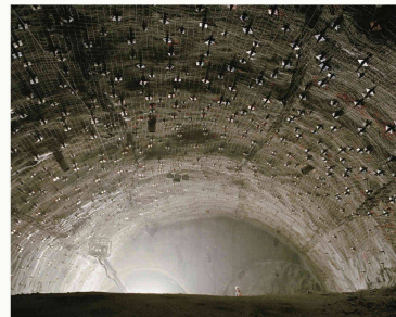
Têtes d'ancrages, Sud du tunnel de base du St-Gothard (Photo Milo Keller/FCAJ)
