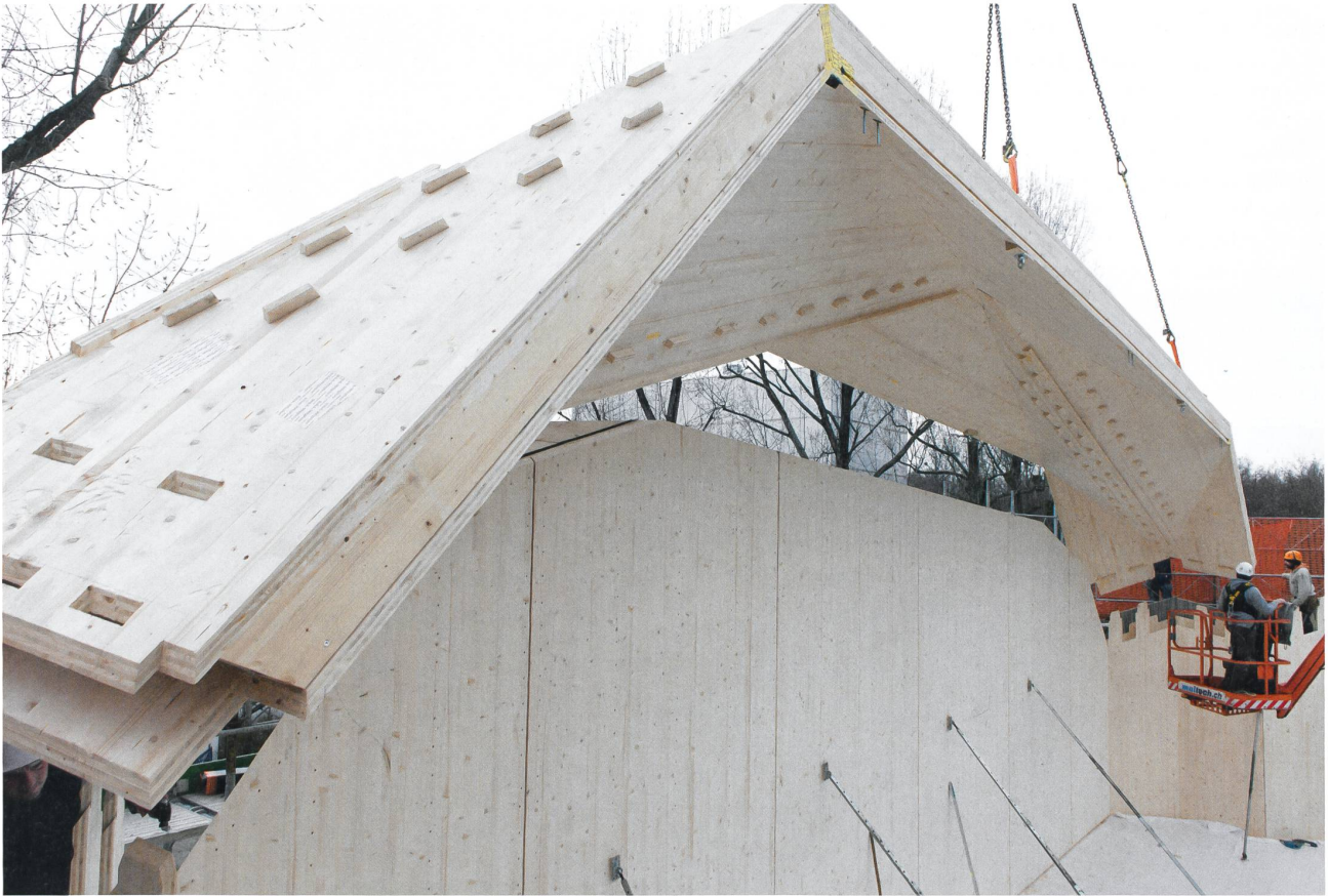
3, 4 Pose de l'une des arches du pavillon, 24 avril 2017 5 Pose de la première arche du pavillon, 6 janvier 2017
