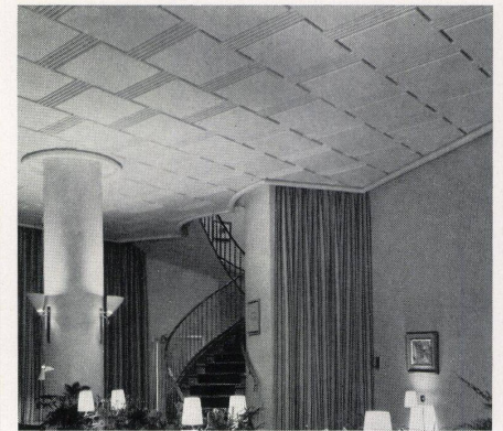
Abb. 9. Café Luxor in Zürich. Architekt A. E. Boßhardt, Zürich. Gelochte «Soundex»-Gipsplatten, 600×600×29 mm, mit Mineralwolle, auf 24 mm Lattenrost, Luftzuführung durch die Platte, siehe Abb. 1, Gesamtfläche 70 m 2 . Ausführung: Isolag, AG. für Isolierungen in Zürich.
