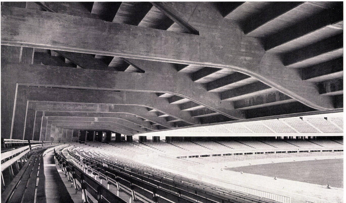
3 Blick vom hinteren Teil der unteren Rampenpartie, die von der mittleren Rampenpartie überdeckt wird. Vue depuis la partie arrière de la tribune inférieure, recouverte par la tribune du milieu. View from back of lower stand, which is overhung by the middle section.
