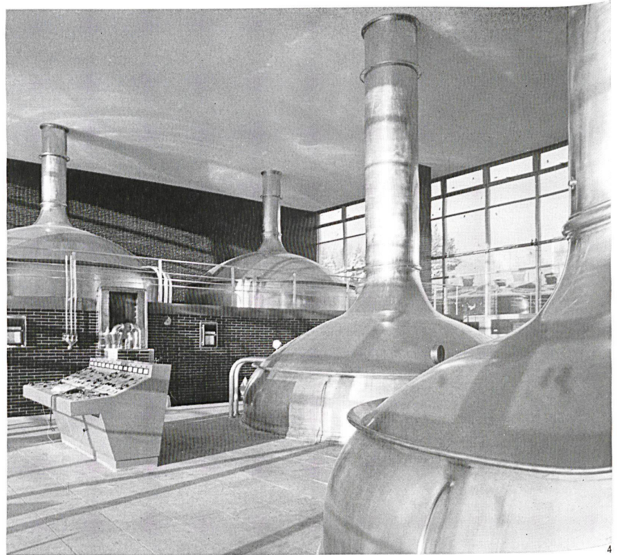
4 Brauereihalle mit Kupferkesseln. Die Wand ist mit schwarz glasierten Platten verkleidet. Brasserie avec marmites en cuivre. Murs revêtus de catells noives émaillés. Main hall of brewery indicating brass drums. The wall cladding in black glazed tile.
