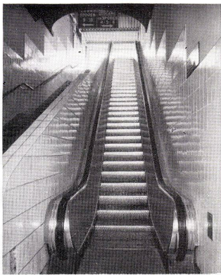
7 Fahrtreppe von 7 m Förderhöhe auf dem Bahnhof Mecheln, Belgien. 8 U-Bahnstation in Wandsbek-Markt, Hamburg. Zwei Fahrtreppen des östlichen Ausganges. 9 Zwei Fahrtreppen des Fußgängertunnels Opernplatz in Wien.
