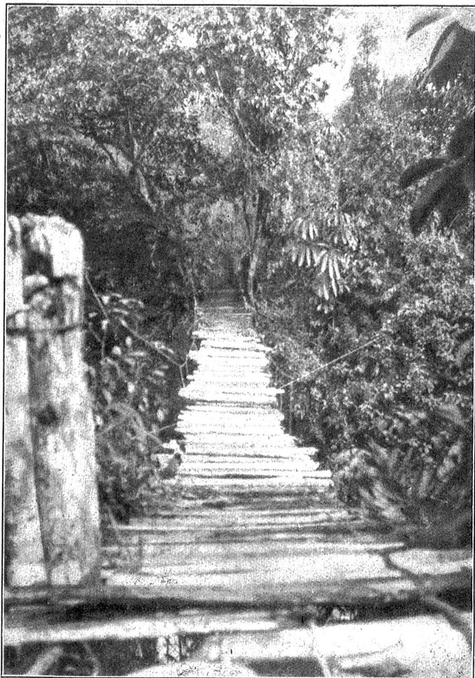
Morsche Drahtseilbrücke über die Schlucht des Rio Jondachi.
