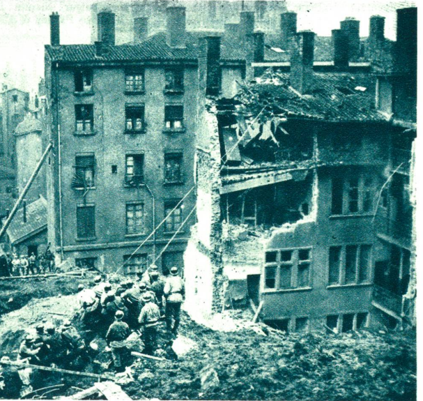
Zu der Einsturzkatastrophe in Lyon. Gefährdete Häuser, die niedergerissen werden.
