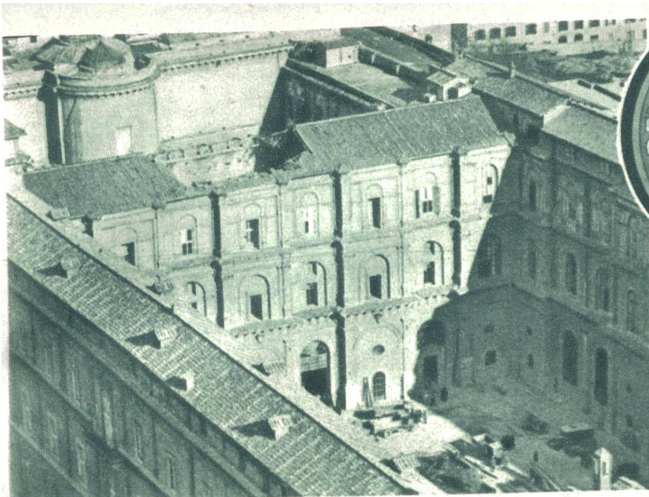
Die Einsturzkatastrophe in der Vatikanischen Bibliothek. Blick auf den Querbau im Vatikan, der vom Dach bis auf den Erdboden durchschlagen wurde.
