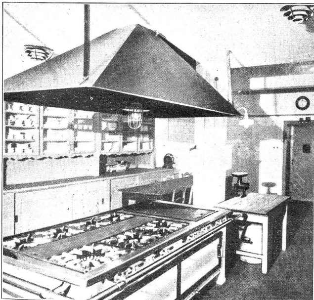
Künstliches Klima in der Küche! Die warme Luft wird durch den über dem Herd liegenden Schornstein abgesaugt; die Zuführung der künstlich vorbehandelten Luft erfolgt durch die an der Decke sichtbaren Apparate.
