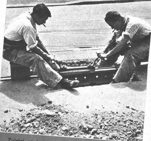
Zuletzt wird die ganze Schweißstelle, soweit sie befahren wird, mit dem Schienenhobel abgeglättet
