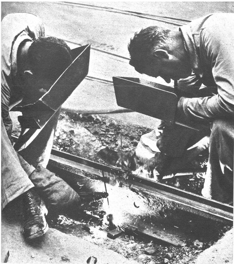
Vorerst wird eine Flusseisenplatte unterlegt und verschweisst, sodann die Lücke im Schienenkopf und im Steg mit Schweißgut ausgefüllt
