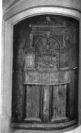
Vorstülpige Barocktüre des Hauses Kesslergasse 2. Hier der fehlende Türklopfer sollte ersetzt werden
