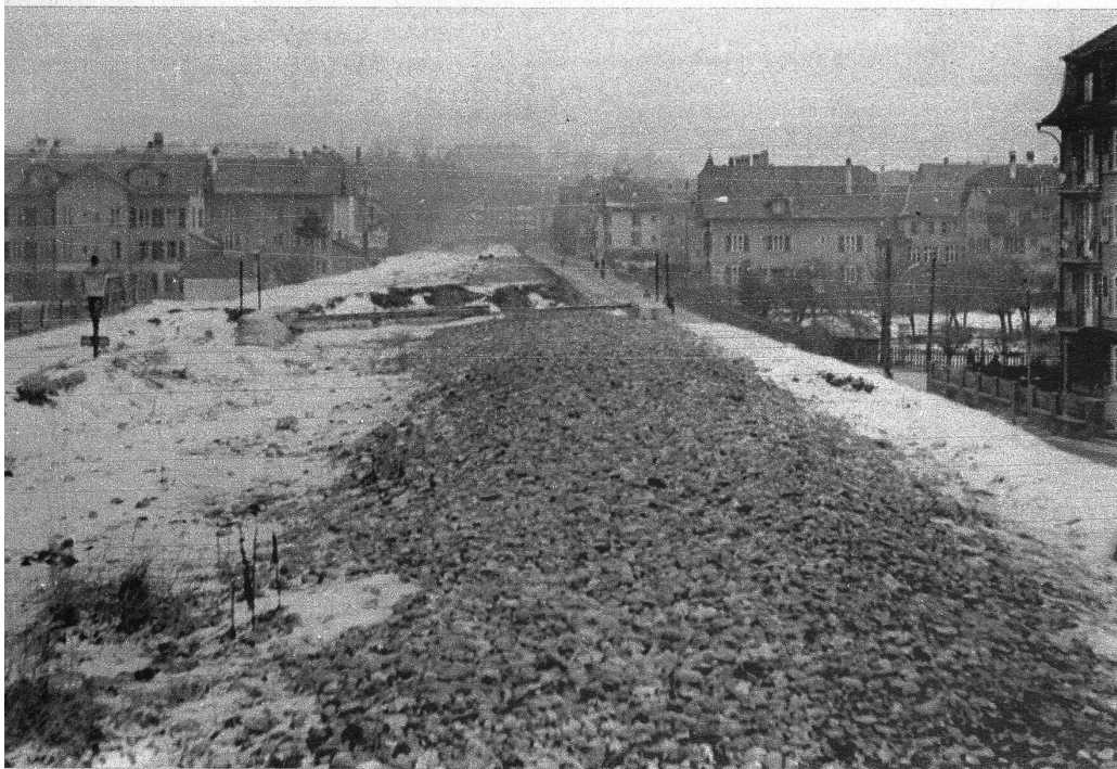
Die Nordringstrasse im Bau. Sie soll die «Grande Avenue» von Bern werden
