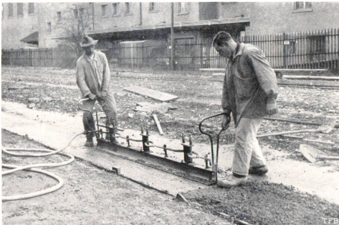
Abb. 1 Oberflächliche Vibration mit dem «Vibropil» - bei einer Betonstrasse im Güterbahnhof Zürich - Bauleitung: Betonstrassen A.-G., Wildeg; Unternehmung: Prader & Cie., A.-G., Zürich.
