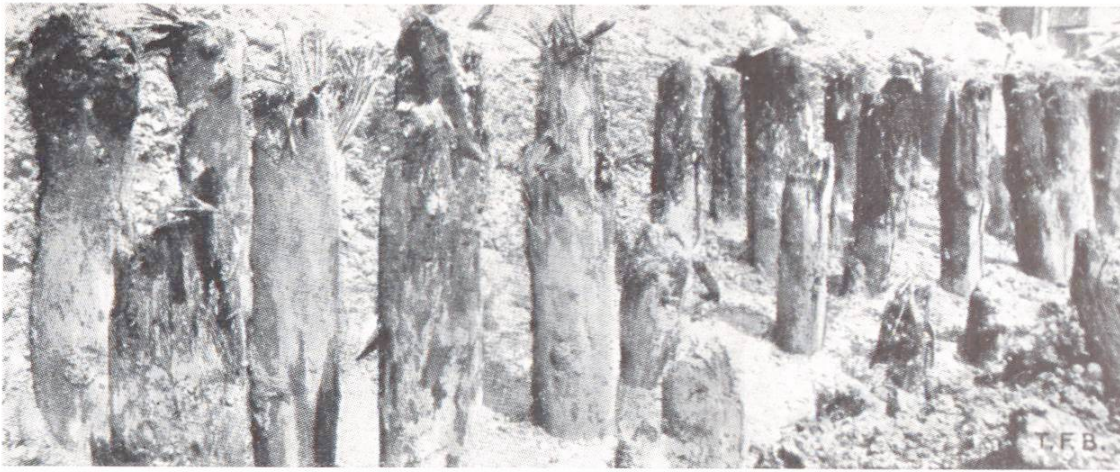
Fig. 5 Abgefaltete, hölzerne Pfahlköpfe, Zersetzung der über dem Grundwasserspiegel liegenden Partien (Phot. Raymond, NYC)
