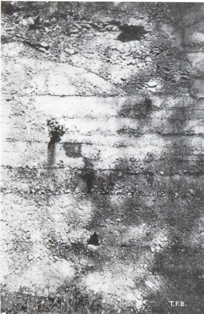
Abb. 3 Die Folgen der Entmischung: Kiesnester, namentlich in den unteren Lagen der einzelnen Schüttungen
