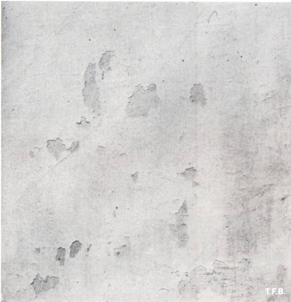
Abb. 3 Ablätterung von Fassadenanstrich, der mit einem ungeeigneten Zusatzmittel versetzt wurde
