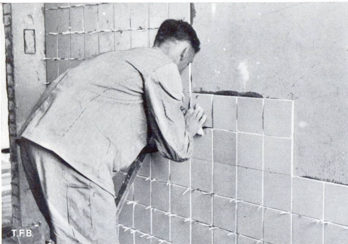
Abb. 6 Die letzte Platte einer Reihe wird zurechtgerückt. Man beachte die Sicherung einer gleichmässigen Fugenweite
