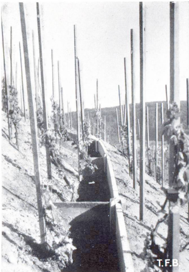
Abb. 3 Schwemmgraben mit armierten Betonschwemmbrettern gesichert, Unterteilung mit Querbrettern zur Erhöhung des Fassungsraums der Graben für Schwemmmaterial
