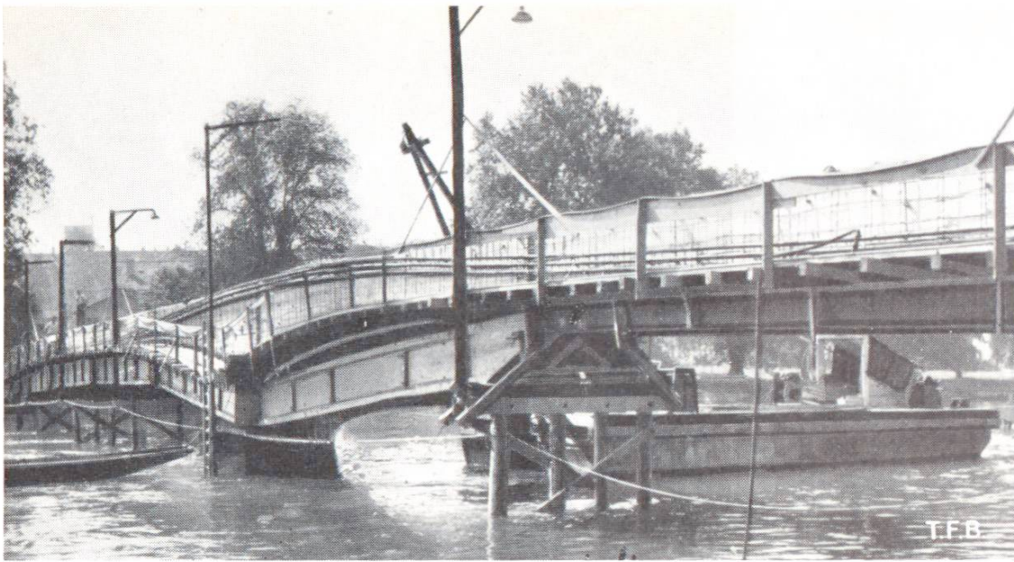
Abb. 14 Aaresteg Aarau, Bauzustand vor dem Einschalen einer Tragrippe, 3 Kabel à 80 Tonnen, über dem Flusspfeiler hochgekrümmt, im Vordergrund Lehrgerüst aus Stahlprofilen, dahinter aus verleimten Holzträgern
