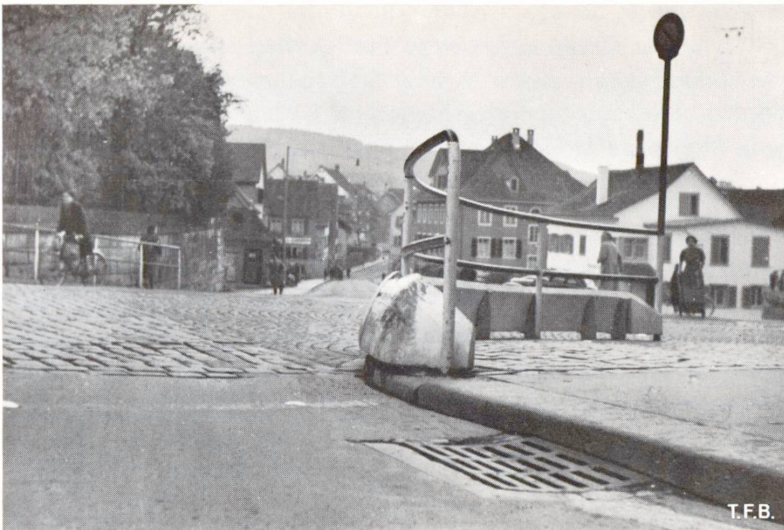
Abb. 6 Sicherheitszaun an stark gefährdeter Trottoirecke. Die Spuren der sehr intensiven Beanspruchung der Leitschranke sind deutlich sichtbar
