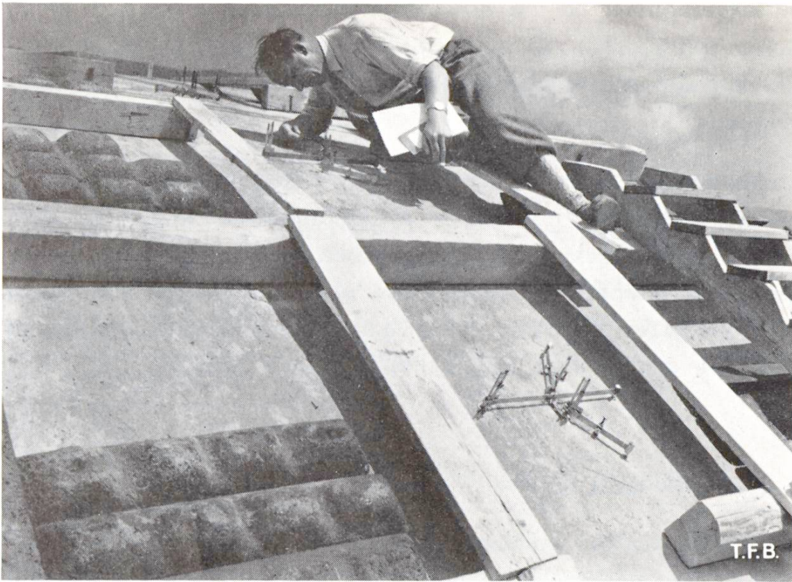
Fig. 5 Belastungsprobe am ausgeführten Bauwerk. Von grossem Interesse war ein Vergleich des Verhaltens des wirklichen Bauwerkes und des Modelles. Durch die EMPA sind umfangreiche Messungen vorgenommen worden. Auf dem Bild sind sternförmig montierte Tensometer sichtbar, die am entsprechenden Schalenteil die Dehnungen messen, welche am Modell durch die Dehnungsmessstreifen ermittelt wurden
