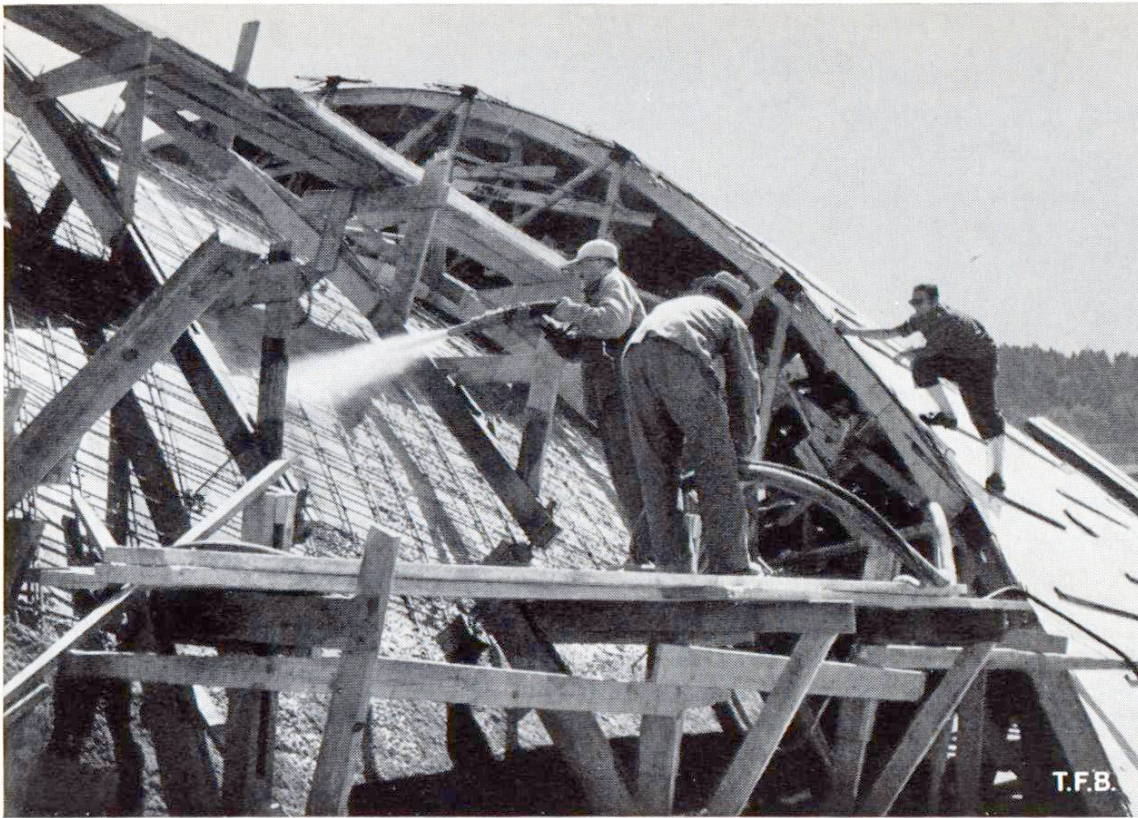
Abb. 5 Die Schalen wurden im Spritzverfahren ohne Konterschaltung betoniert (P 325, Kiessand 0/20 mm). Sie sind vom Scheitel bis zum Auflager zunehmend 7 bis 12 cm dick
