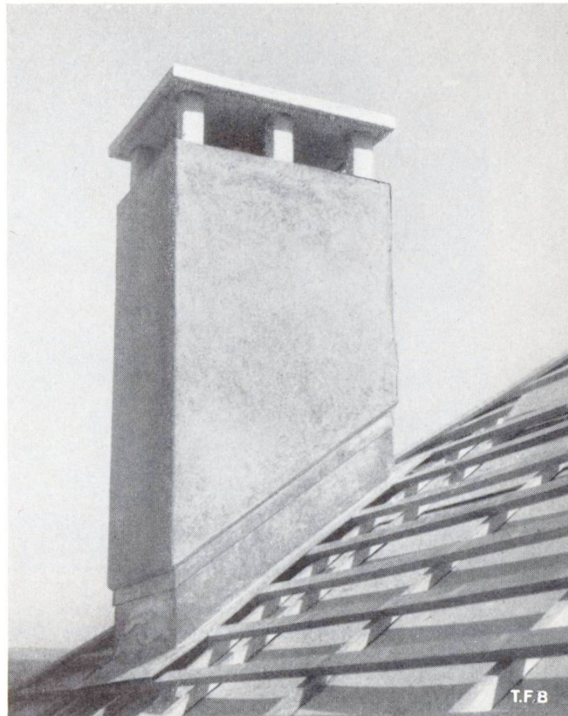
Abb. 4 Mit hydraulischem Kalkmörtel verputztes Kamin. Feuchtigkeits- und Temperatureinwirkungen sind bei einem solchen Bauteil, sowohl von innen als auch von aussen, besonders ausgeprägt. Dies, wie auch der Anschluss an die Dachbedeckung, verlangen eine aussergewöhnliche Fähigkeit der Verputzschichten zur räumlichen Angleichung
