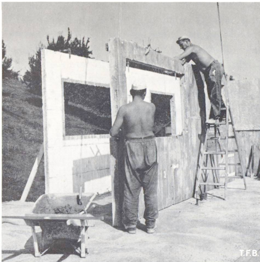
Abb. 3 Montage von auf der Baustelle vorgefertigten Betonelementen. Die Aussenwandteile werden hier aus zwei kongruenten Betonplatten gebildet, wobei die äussere bereits mit einer Isolationsschicht belegt ist. Die doppelte Ausführung lässt sich vermeiden, indem für den Beton ein wärmedämmender Leichtzuschlag, z.B. Leca, verwendet wird. Man erkennt auch die Aussparungen im Beton der Innenwand für die Installationen. Diese sind genau eingeplant und wurden mittels Holz- oder Schaumstoffeinlagen erhalten.
