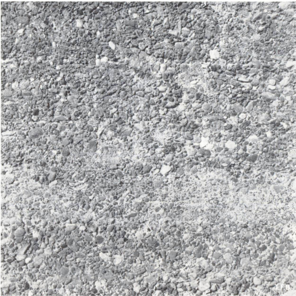
Abb. 2 Waschbeton mit normalem 30er-Rundkies mit Stellen leichter Entmischung.
