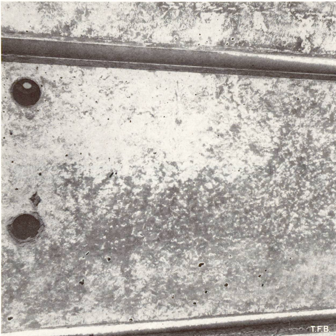
Abb. 1 Hell-Dunkel-Sprenkelungen oder -Marmorisierungen sind ein Zeichen für Entmischungen zwischen Wasser und Zement bzw. für lokale Veränderungen des Wasserzementwertes. Mit HK-Beigabe können solche Schäden besser vermieden werden.
