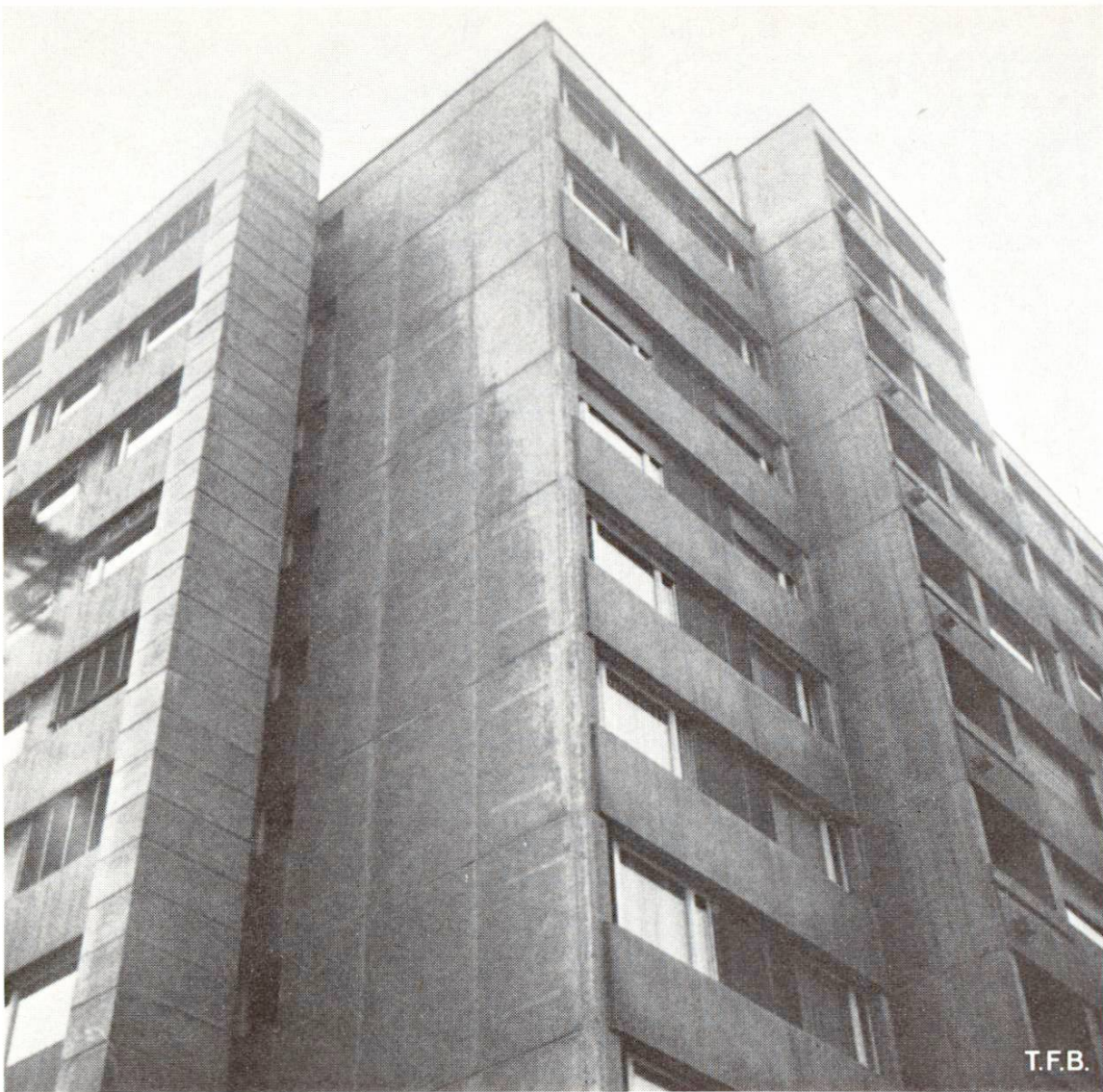
Abb. 2 Fassadenteil mit sichtbarem Einfluss von Schlagregen.
