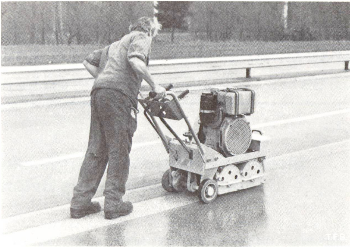
Abb. 1 Oberflächenbehandlung des Betonbelages einer Autobahn. Die Maschine erwirkt eine gleichmässige und regulierbare Aufrauung der Oberfläche mittels einer gesteuerten, aber nicht aufgezwungenen Schlagwirkung. Zusätzlich ist eine automatische Korrektur der Ebenheit der zu behandelnden Oberfläche durch eine Vorrichtung für ein selbständiges Ausgleichen mit stufenweisem Fortschritt eingebaut, nebst einer steuerbaren Geschwindigkeit des automatischen Vortriebes (Fabrikat: Maschinenfabrik von Arx, Sissach, Schweiz).
