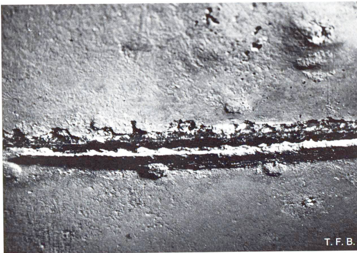
Abb. 11 Rostiges Armierungseisen; Eisen viel zu nahe an der Betonoberfläche!
