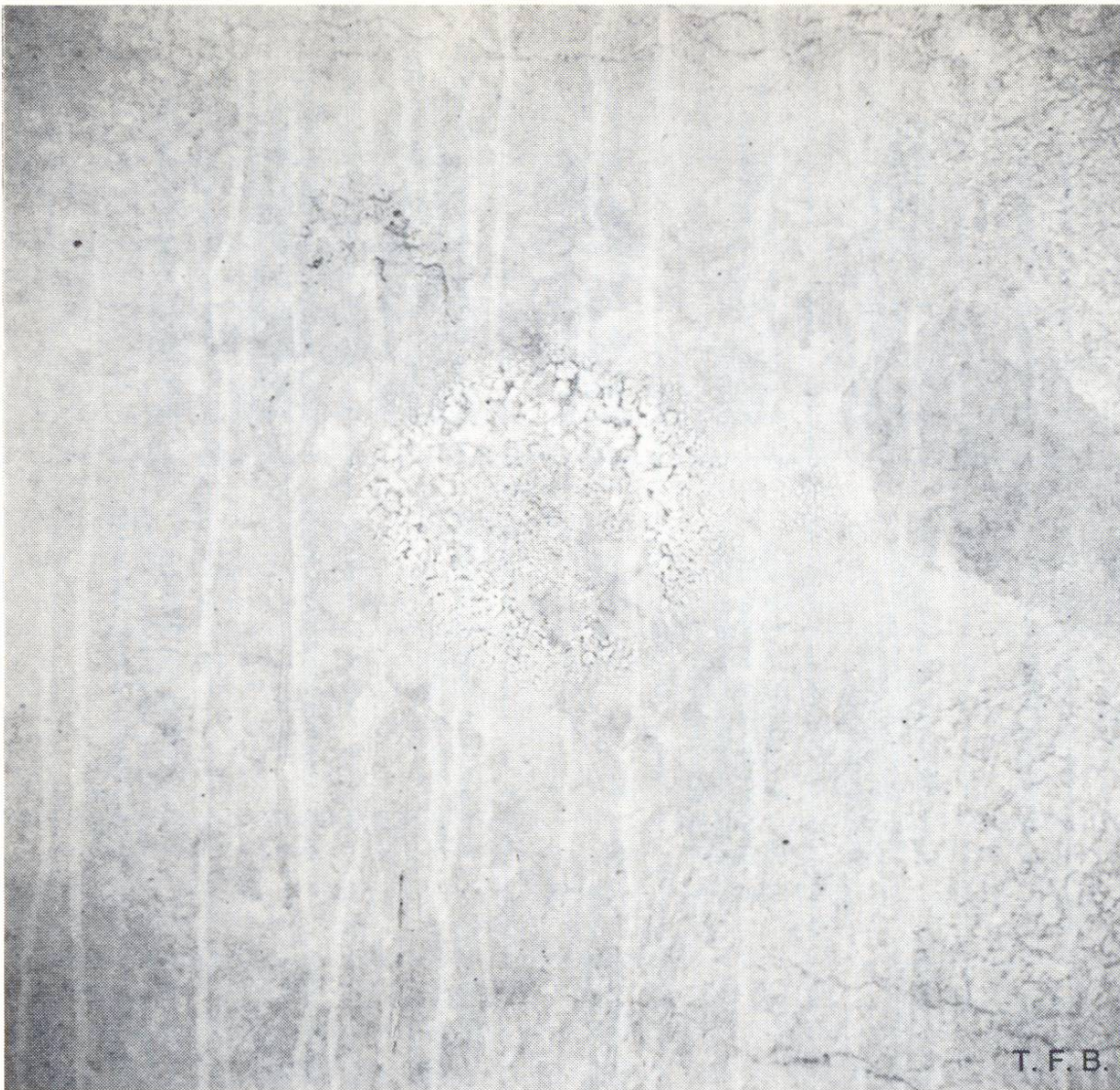
Abb. 3 Zwischen Beton und liegender Schalung eingeschlossenes flüssiges Schalungsöl wird durch die Vibration in kleine Einzeltropfen aufgeteilt, die sich in der Betonoberfläche abzeichnen
