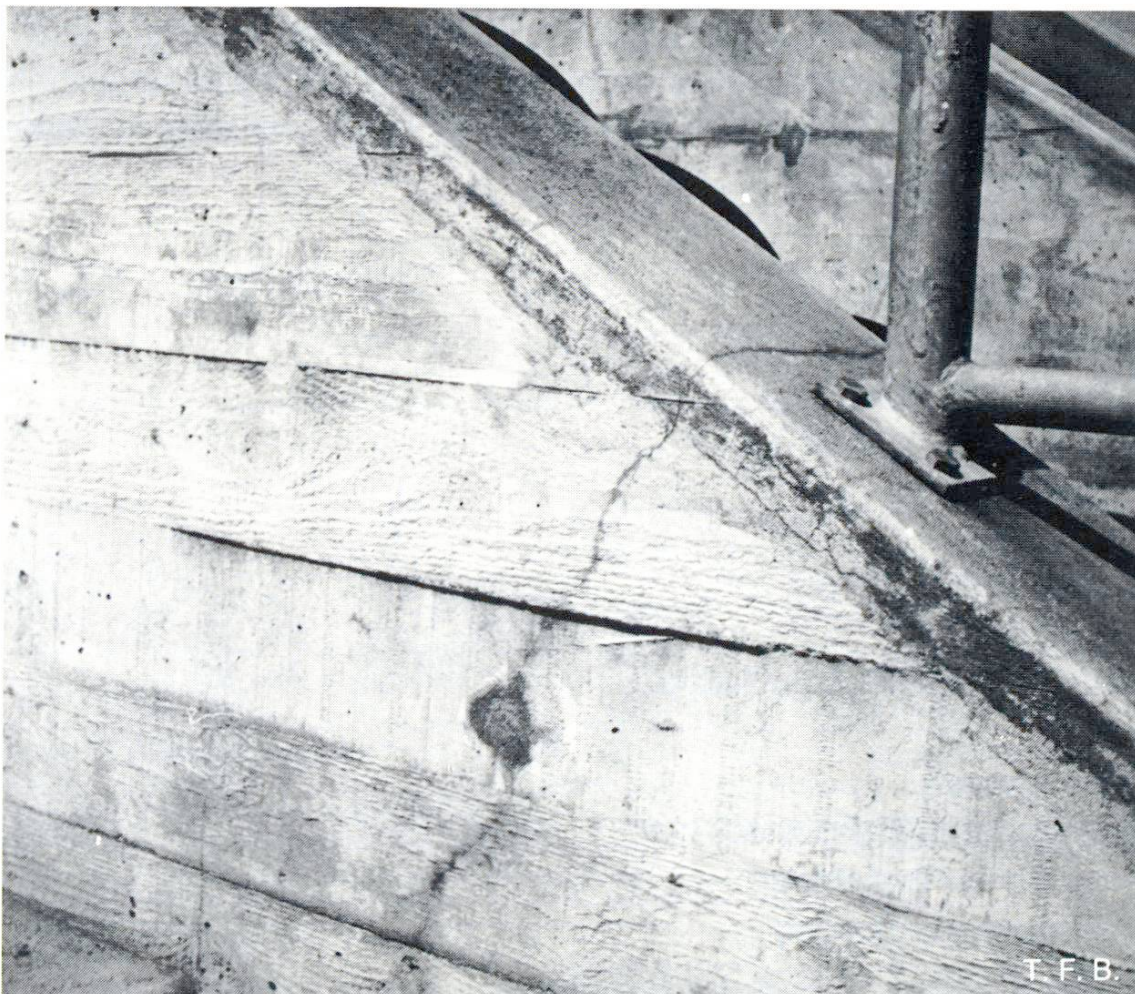
Abb. 4 Auch die nachträgliche Herstellung einer glatten Krone an einer Sichtbetonmauer kann als Reparatur angesehen werden. In solchen Fällen sollte man wenn immer möglich die Krone unmittelbar nach dem Betonieren, ohne Hinzufügung von Mörtel, abreiben, glätten und formen.
