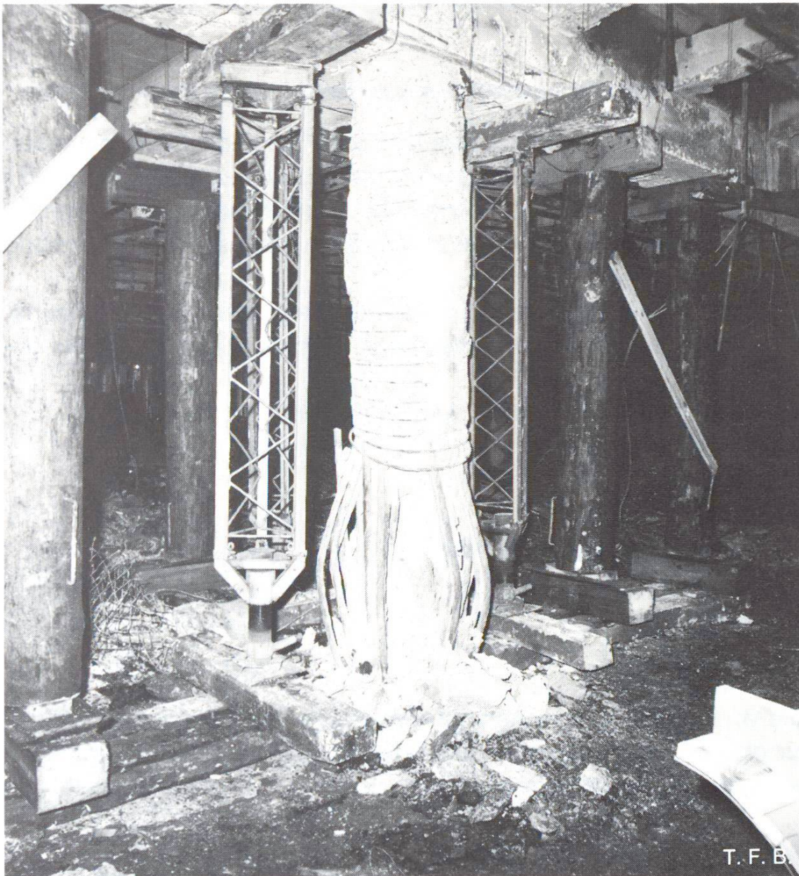
Abb. 1 Hochbelasteter Betonpfeiler nach Brandeinwirkung an der Grenze seiner Tragfähigkeit. Man erkennt, dass die Eisenüberdeckung an der Säule und am Unterzug gering war. Mit etwas mehr wäre der Zustand weniger kritisch geworden (Foto: Feuerwehr und Katastropheneinsatz – Lichtbildstelle).
