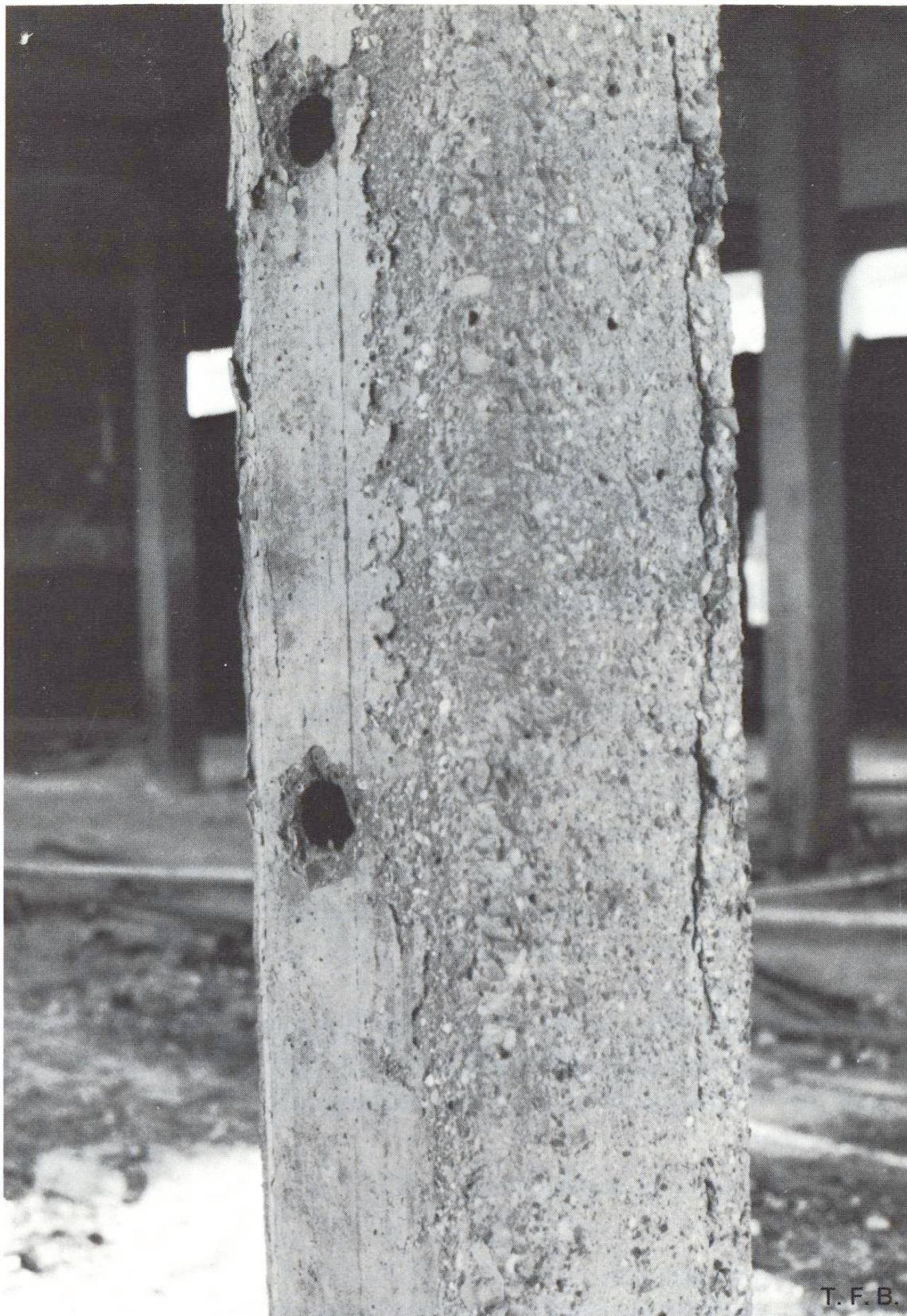
Abb. 2 Einfache schlanke Betonstütze blieb trotz starker einseitiger Hitzebelastung funktionstüchtig.
