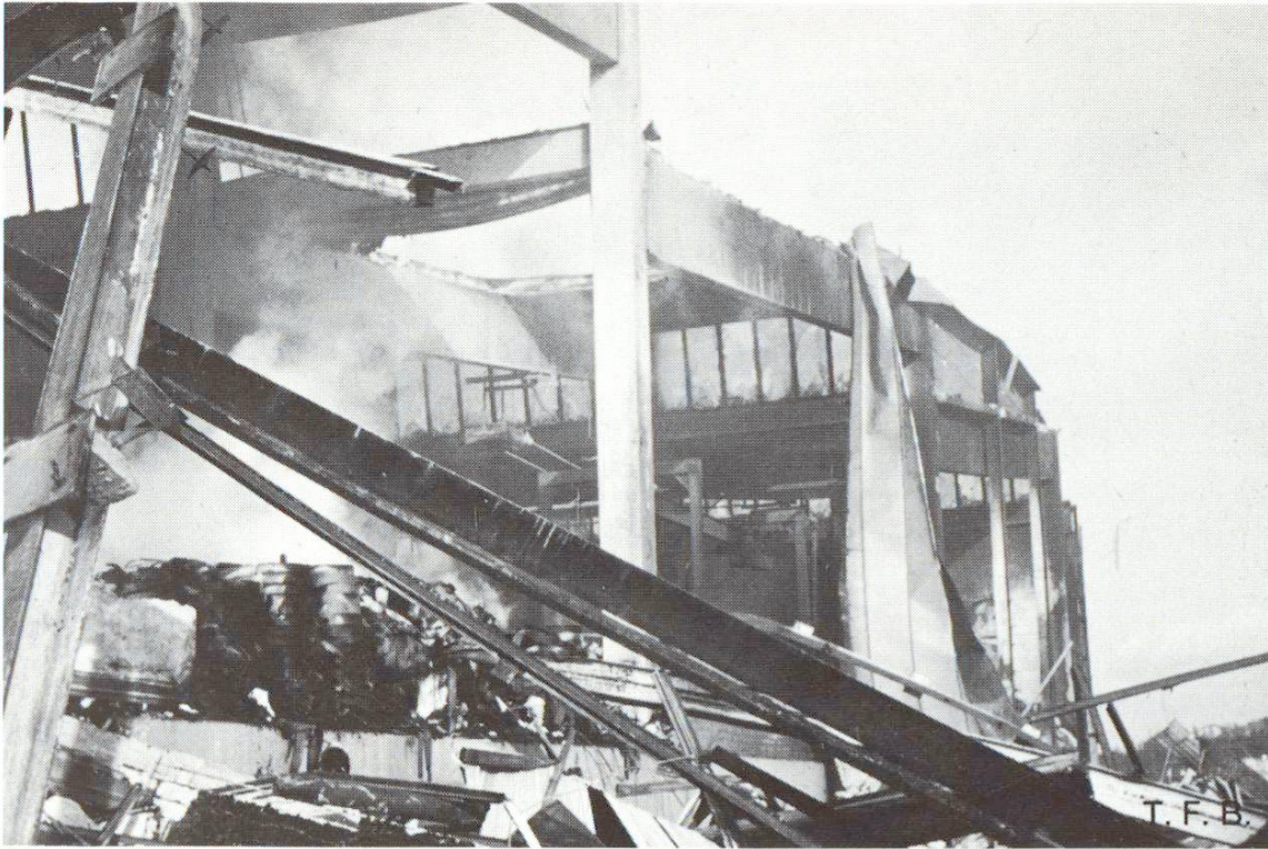
Abb. 5 Das unterschiedliche Verhalten von Metall- und Betonkonstruktionen bei starken Bränden ist auf diesem Bild erkennbar.
