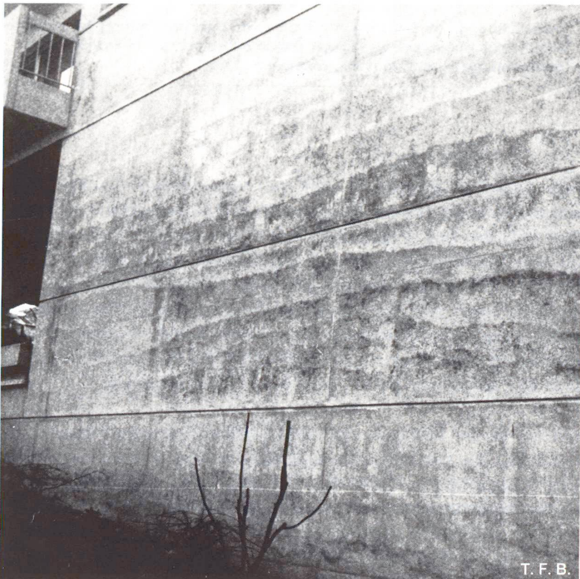
Abb. 1 Die einzelnen Betonschüttungen zeichnen sich durch schwarze Verfärbungen ab, welche auf Nachverdichtung im Stadium des Abbindebegins zurückzuführen sind.
