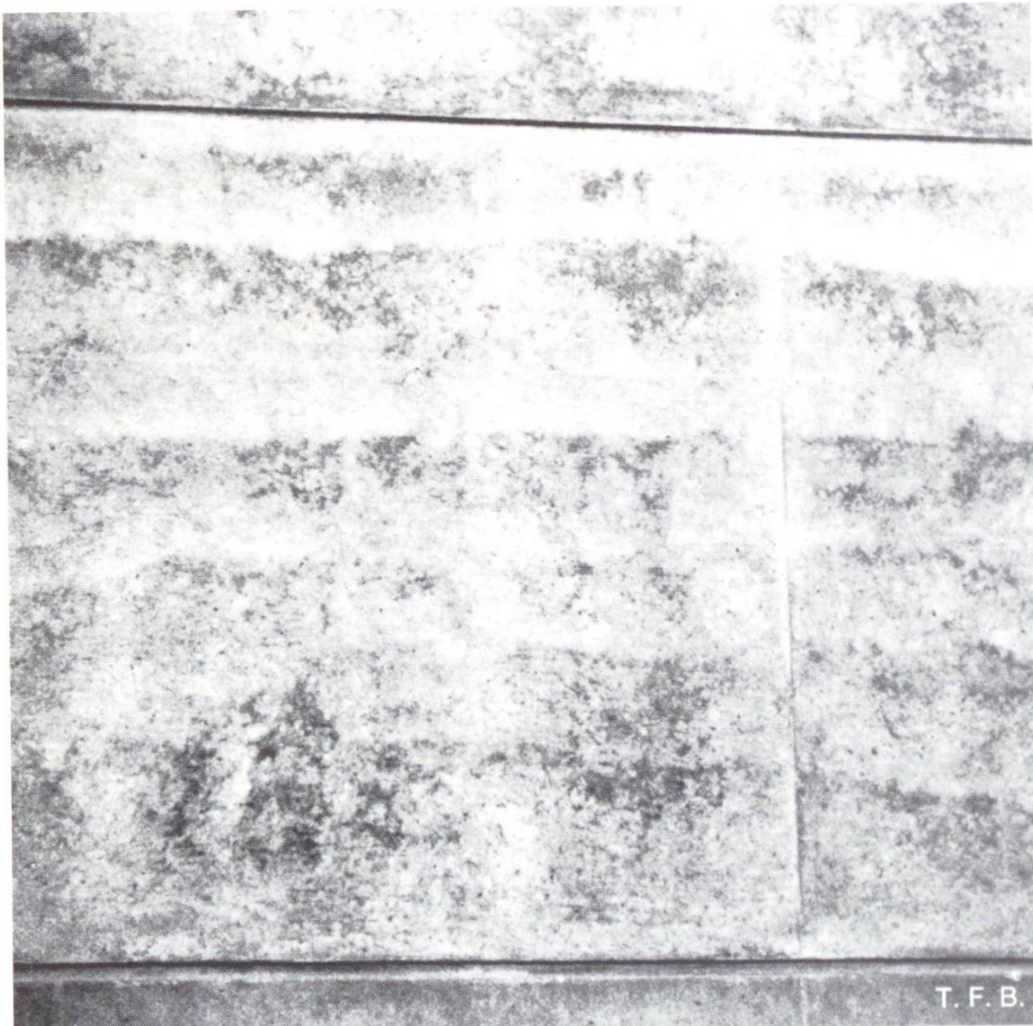
Abb. 3 Ausschnitt aus Abb. 1. Man erkennt die Wirkung einzelner Vibratoreinsätze sowie die mittelbar sich abzeichnende Schalungskonstruktion.
