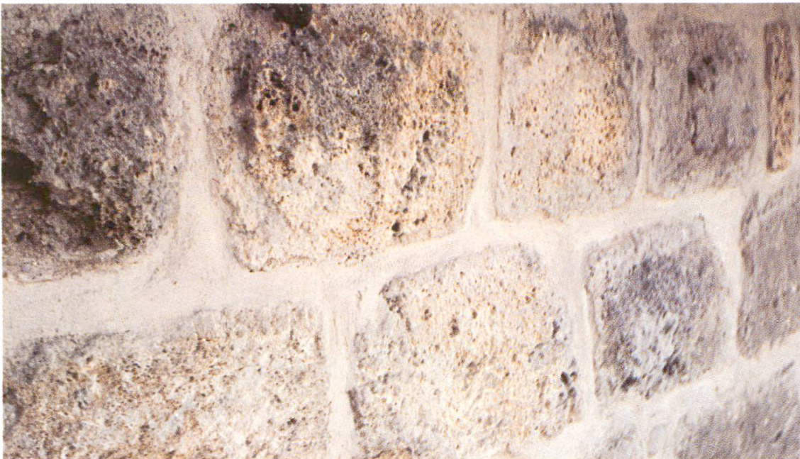
Abb. 8 Der Farbton des Mörtels ist auf den Tuffstein abgestimmt. Als Mörtelsand wurde eine ausgewählte Mischung von Brechsand aus dem Kalksteinbruch Egerkingen angewendet. Wichtig ist der dichte, rissfreie Anschluss des Stopfmörtels rund um die Quader.
