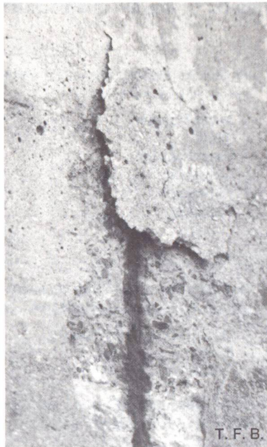
Abb. 5 Aufwölbung und Abplatzung infolge Korrosion der Armierung.
