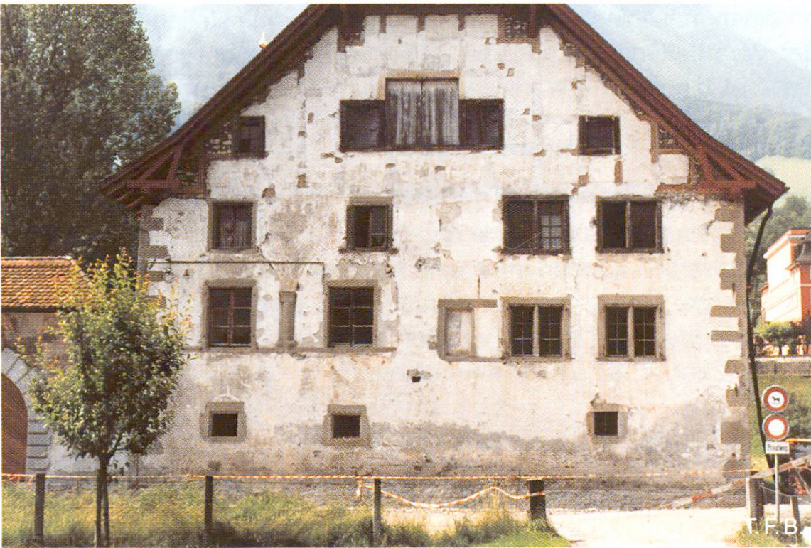
Abb. 2 Deutlich sichtbar ist die vom Fundament her aufsteigende Feuchtigkeit (Winkelriedhaus, Stans, Nordfassade, Juli 1987).
