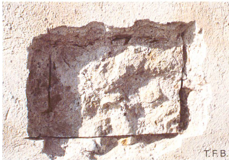
Abb. 9 Nach der Sanierung löste sich der Verputz an verschiedenen Stellen. Auf den Steinflächen sind nur kleine Mörtelreste haften geblieben. Vermutung: Fehlender, erhärteter Anwurf und zu grosse Anwurfstärke.
