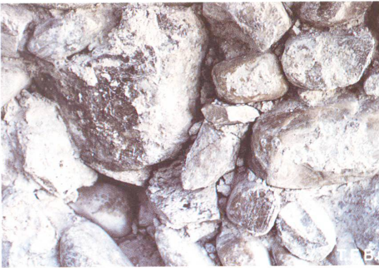
Abb. 7 Das Stopfen einer solchen freigelegten Mauerpartie verlangt Geschick und Sorgfalt des Maurers (Schloss Laupen, Südbau 1986).
