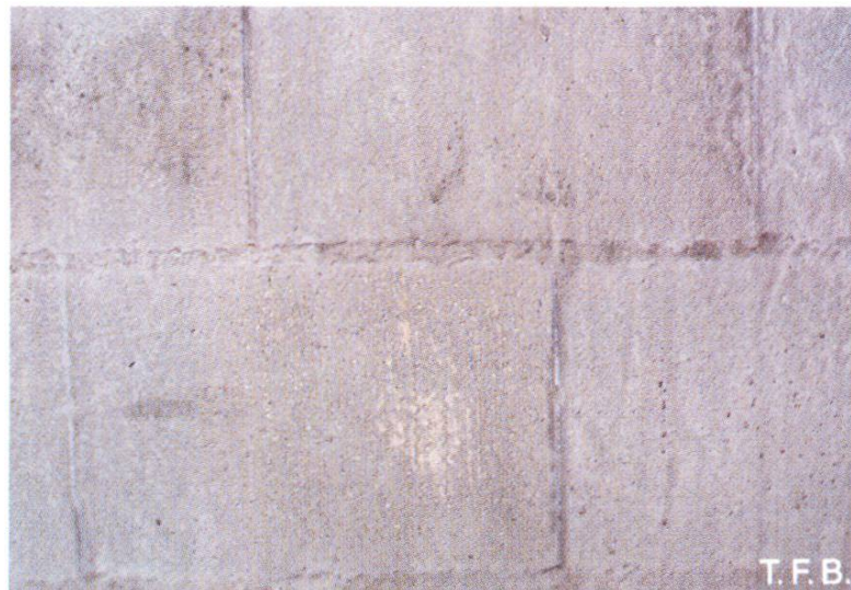
Abb. 10 Dieser «Zementanwurf» gleicht eher einer Glasur. Die dünne, feinkörnige, mit zuviel Wasser angemachte Mörtelschicht «verdurstete» auf dem stark saugenden Backstein und konnte nicht voll erhitzen.
