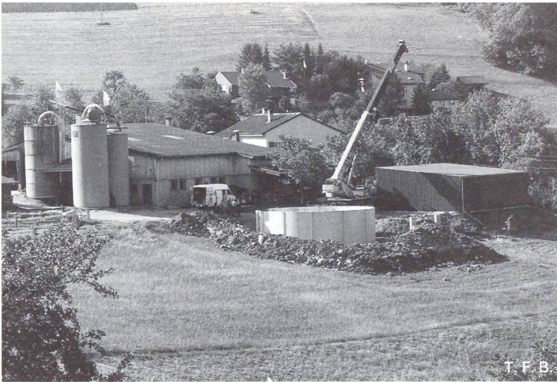
Abb. 14 Güllebehälter nach Montage der Elemente. Hinterfüllen mit Aushub und Gestalten der Böschung zur Abrundung der Hofanlage. Anbringen eines Schutzzaunes, sofern Behälterwand nicht mehr als 1 m über Terrain führt (Buckten, Kanton Baselland).
