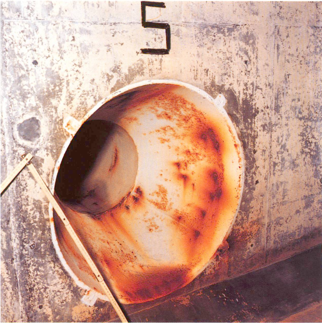
Abb. 3 Auslauftrichter eines Trinkwasserreservoirs nach zehn Jahren Betrieb (St 37 feuerverzinkt mit Kunststoffschutzanstrich).
