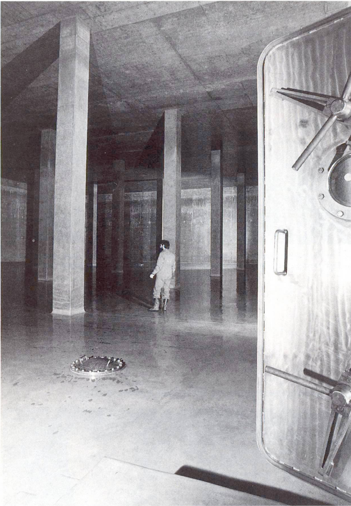
Abb. 10 Einblick in ein Trinkwasserreservoir: Die Baumaterialien sind Sichtbeton und Edelstahl.
