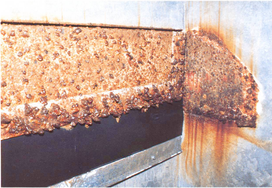
Abb. 5 Korrosionsschaden an Stauklappe eines Aktivkohlefilters nach fünf Jahren Betrieb. Verstärkte Korrosion durch Luft-Wasser-Verhältnisse mit Ozon (gleiche Ausführung wie Abb. 3).
