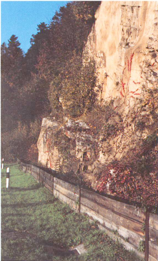
Abb. 13 Saniert wurden nur die gefährlichen Partien
